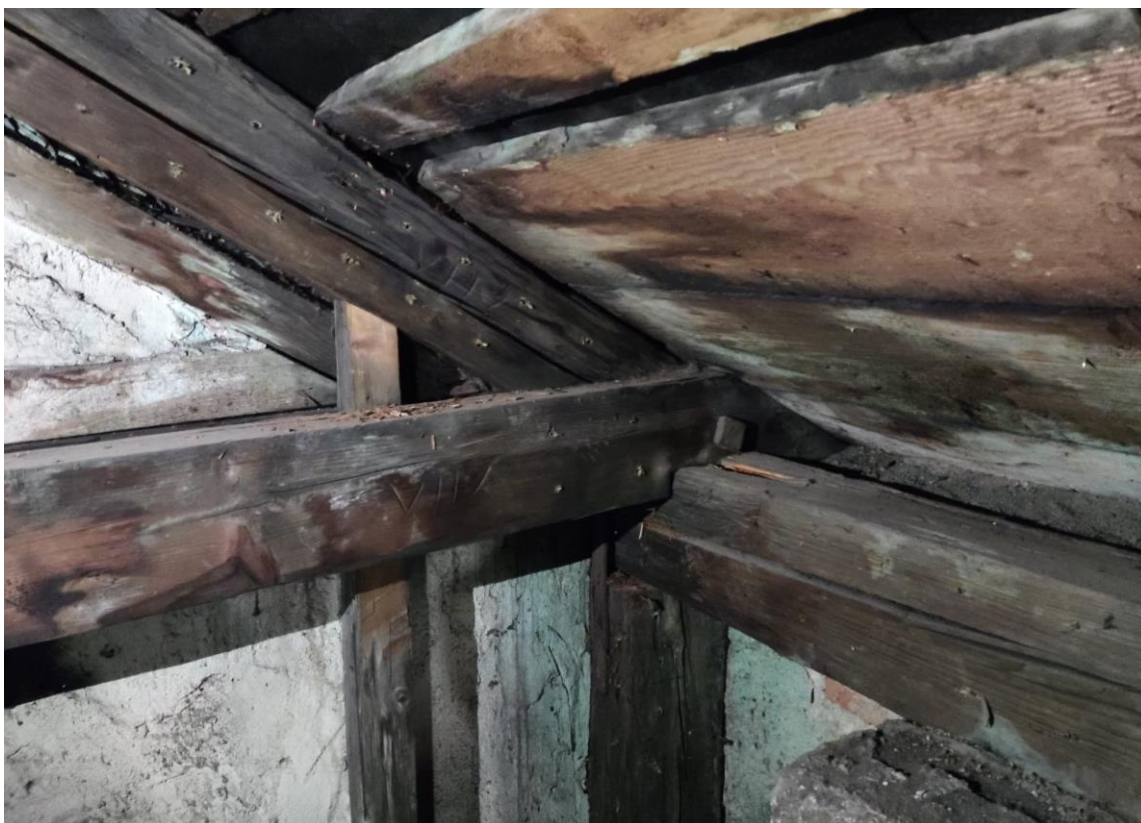
Obr. 11 – napadený spoj pozednice a kleštiny při přizdívce místnosti v západní části objektu
