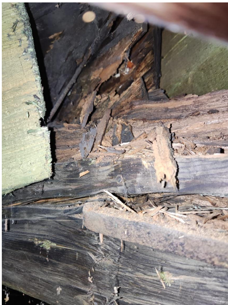
Obr. 4 – degradovaná vrcholová vaznice schodišťového rizalitu – místo odběru vzorku
