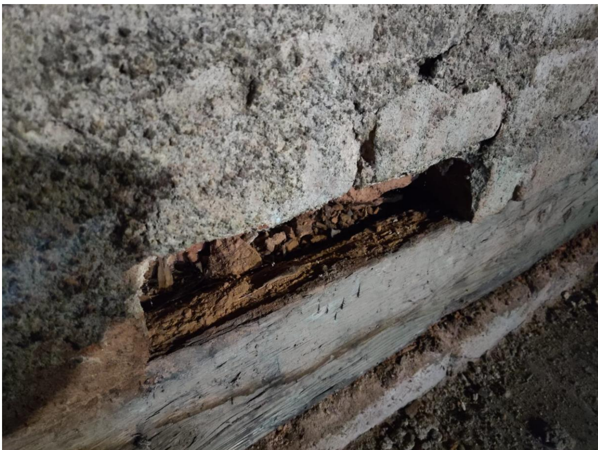
Obr. 6 – degradovaný roznášecí trám zazděný v obvodové zdi
