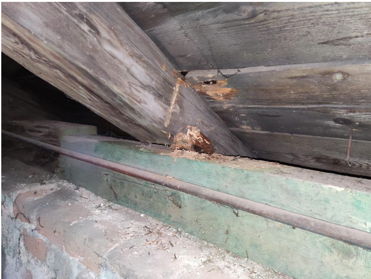
Obr. 5 – degradované zhlaví krokve s již vyměněnou pozednicí při severovýchodním průčelí
