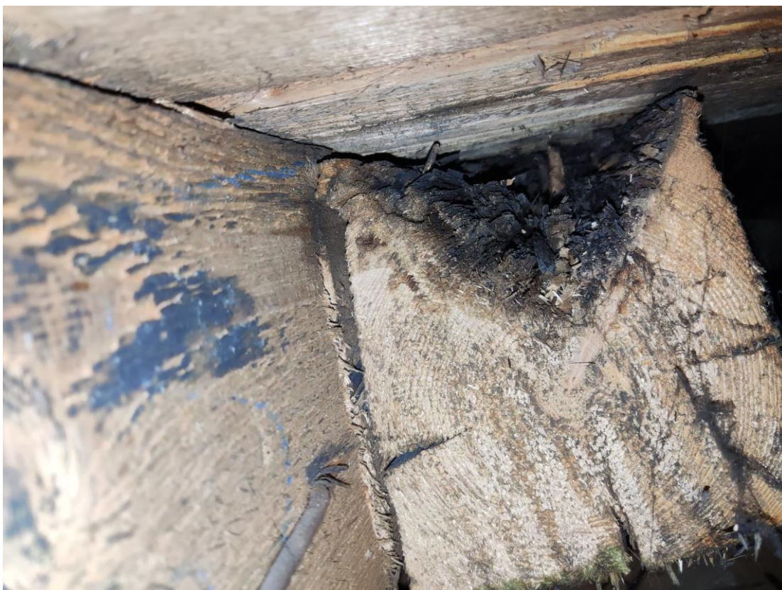
Obr. 9 – degradované zhlaví seříznuté krokve v krovu obloukového průčelí
