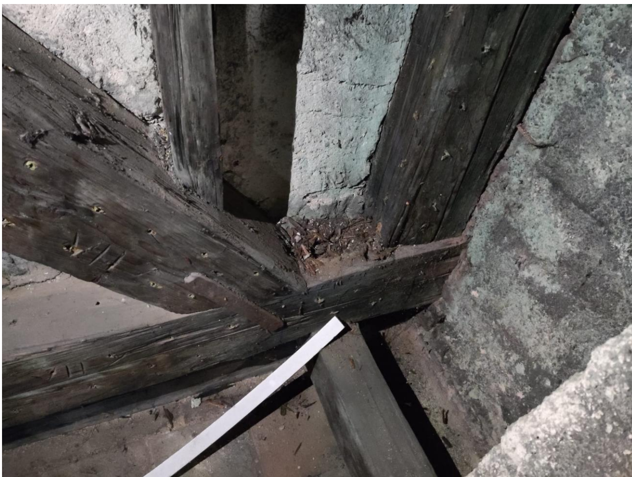
Obr. 10 – napadený vazný trám při přízdívce místnosti v západní části objektu
